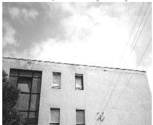
7. ábra Koszorú és fűdém kapcsolata - nem megfelelő hőszigetelés
